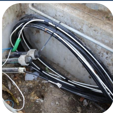
Réseau de fibre optique
